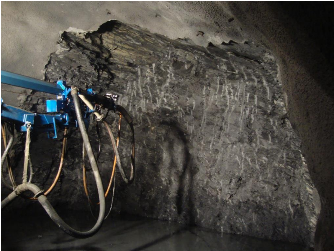
Techo inclinado en Boca Este. Se genera por despegue de estratificación
