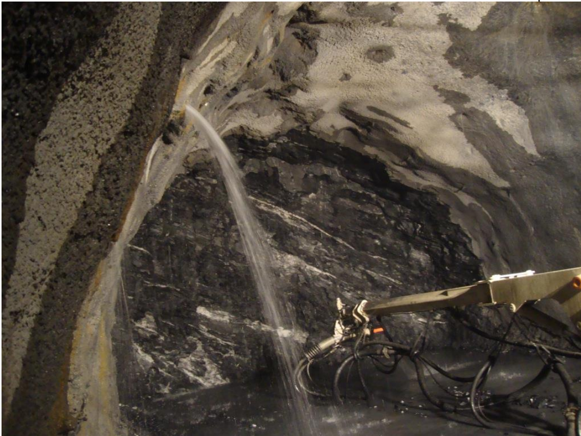
Importante caudal de agua localizado en un punto.
