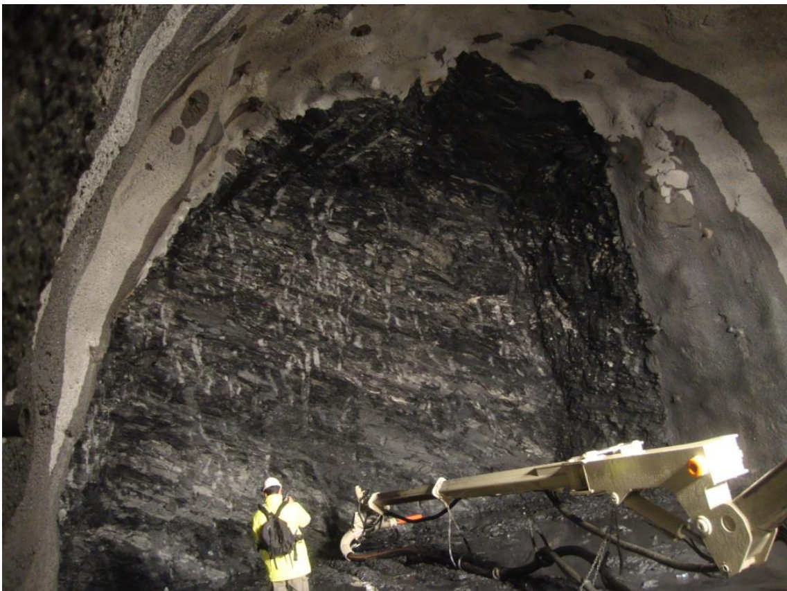
Rotura a favor de estratificación en Boca Este.
